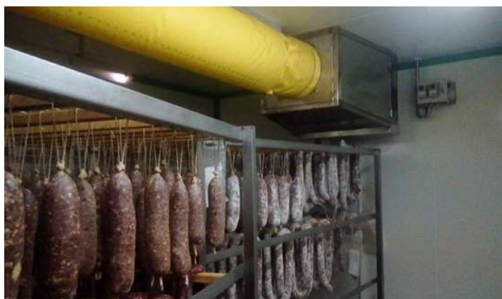
Séchoir fermier avec gaine de répartition
