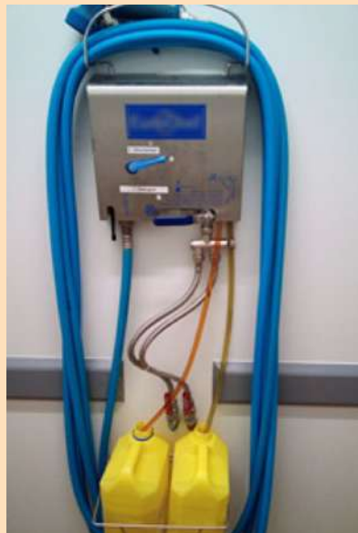
Exemple de centrale de nettoyage
